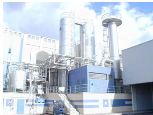
Bild 4: Gesamtansicht der Anlage zum Laugerecycling
