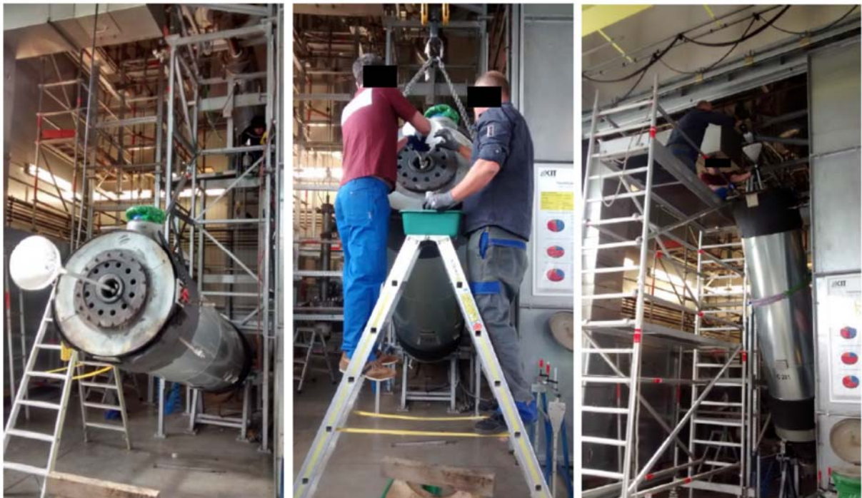
Abbildung 4: Befüllung des Reaktors mit Katalysator.
